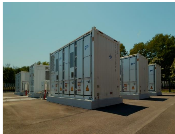
BHEE Talum, 6 MW, Republika Slovenija
