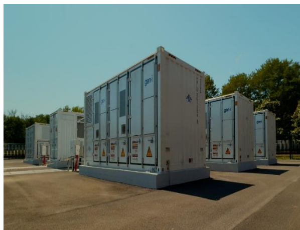
BHEE Talum, 6 MW, Republika Slovenija
